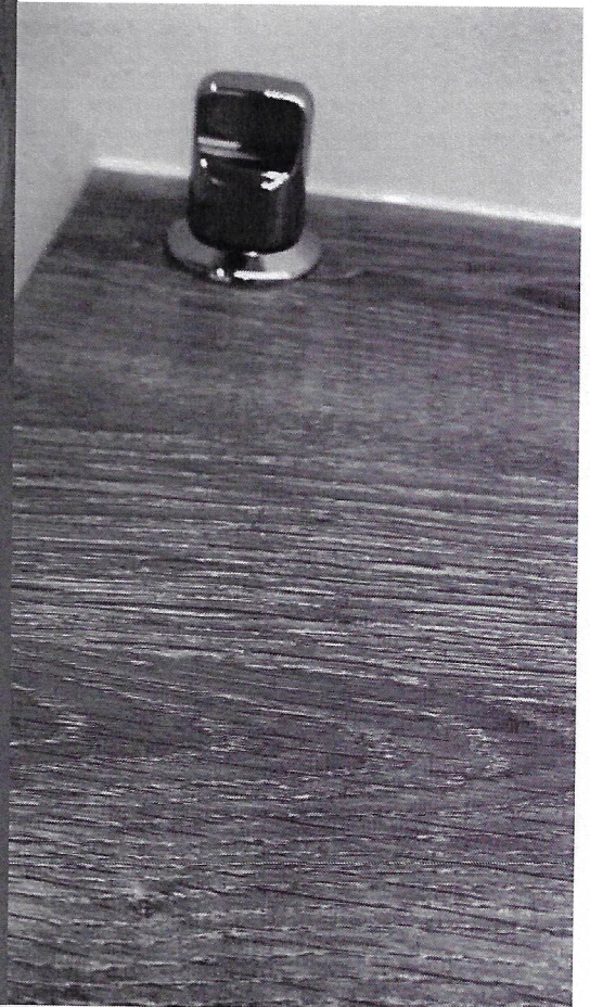
Pöytätasoon asennettu pyykinpesukoneen hana
